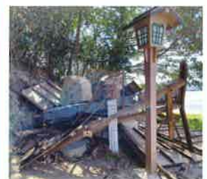
舟島神社(巖流島) 台風被害を修復する工事が 4月から始まりました
